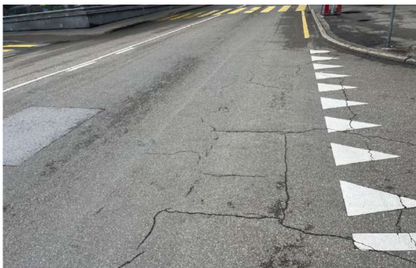
Grand'Rue, état des revêtements bitumineux
