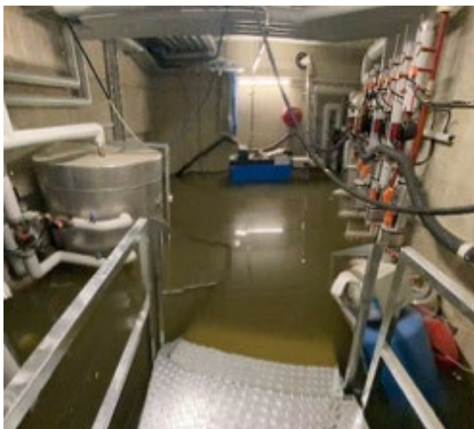
Inondation des sous-sols du bâtiment
