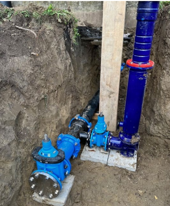
Avenues Général Jomini et du Stade, remplacement de la conduite et BH
